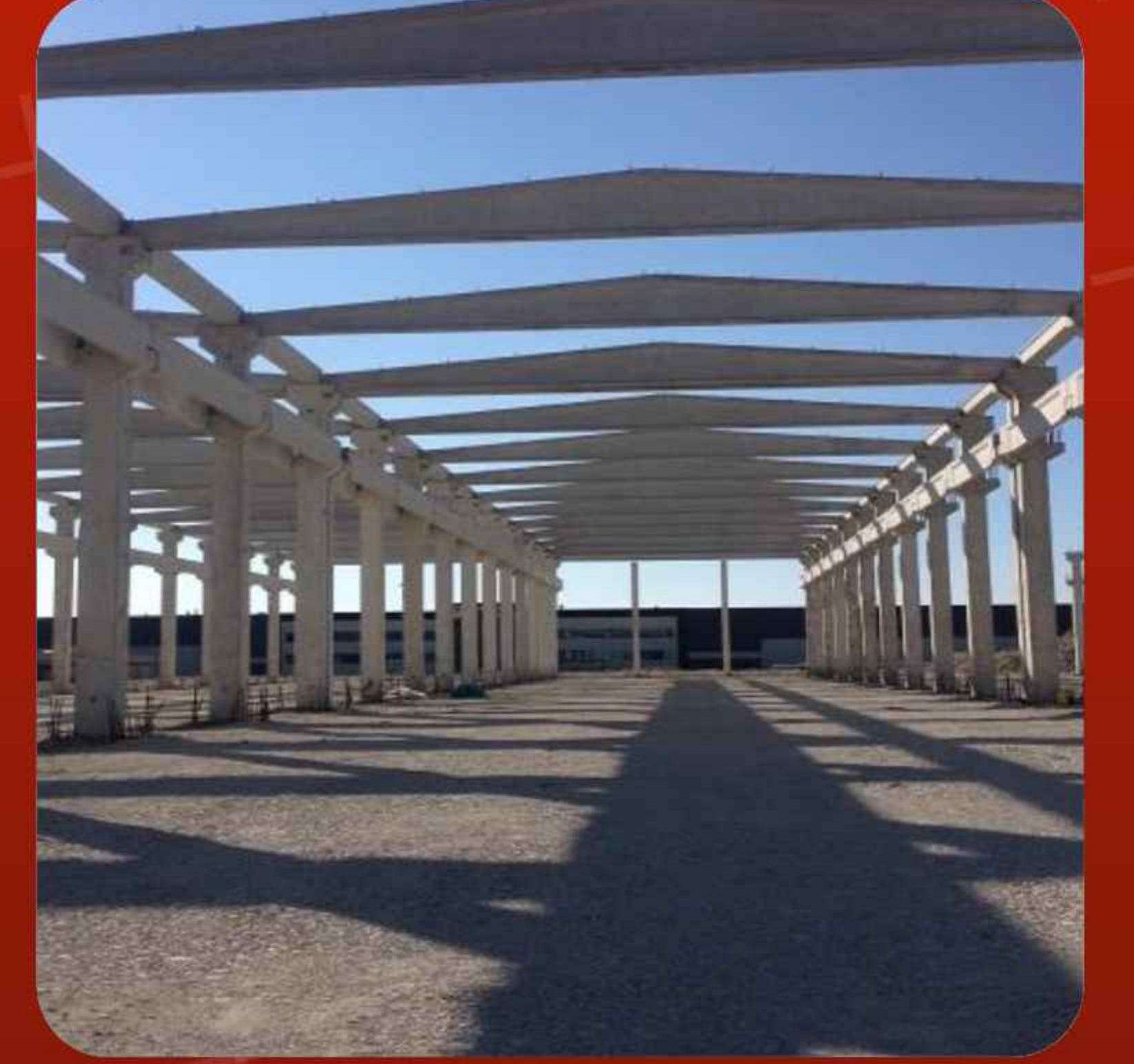
Sönmez Trafo A.Ş Makine İhtisas OSB 15000M2
